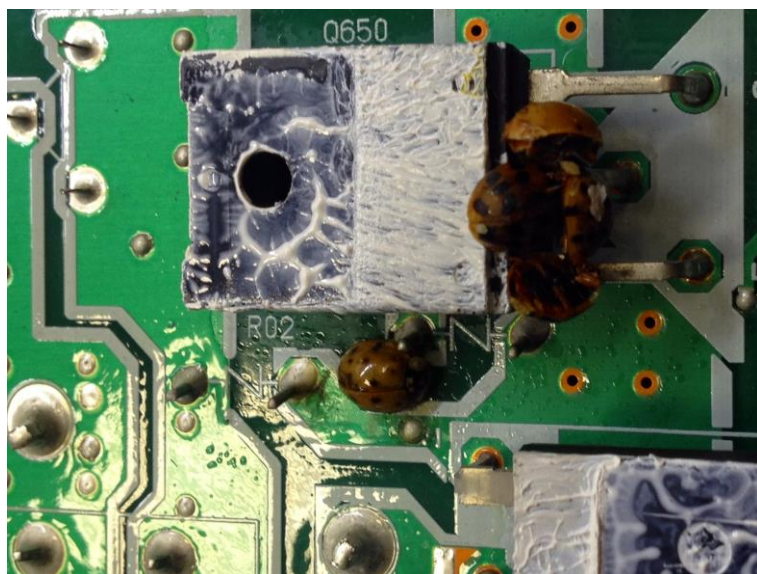
Obrázek 24: Zkrat způsobený těly slunéček východních v elektrickém ovládání domácího kotle. Foto anonymus
